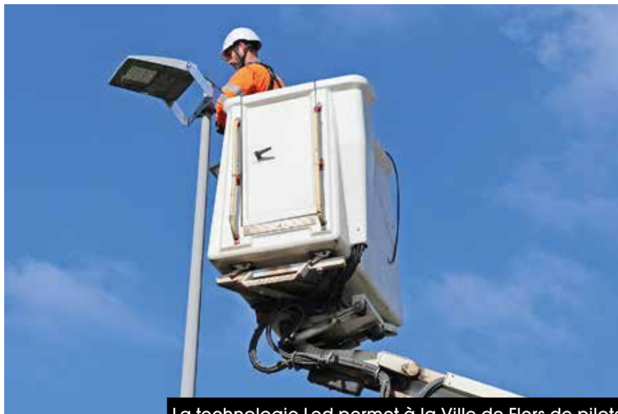
La technologie Led permet à la Ville de Flers de piloter et d'ajuster la puissance lumineuse en fonction des événements.
